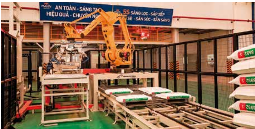
A robot packing line. Two more robot arms are to be installed in Q1, 2019. แผนกลขนถุงอาหารการติดตั้งแขนกลอีก 2 ตัวจะแล้วเสร็จในปี 2562
