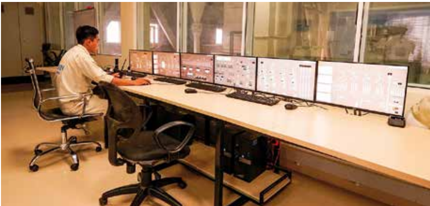
Mill process control ห้องควบคุมการปฏิบัติงาน
